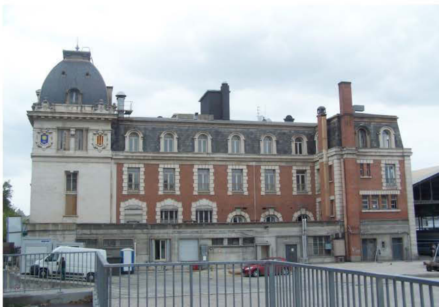
Côté sud de la gare Matabiau, après démolition du centre de tri (Photo Jean-Paul Lasserre du Rozel)
