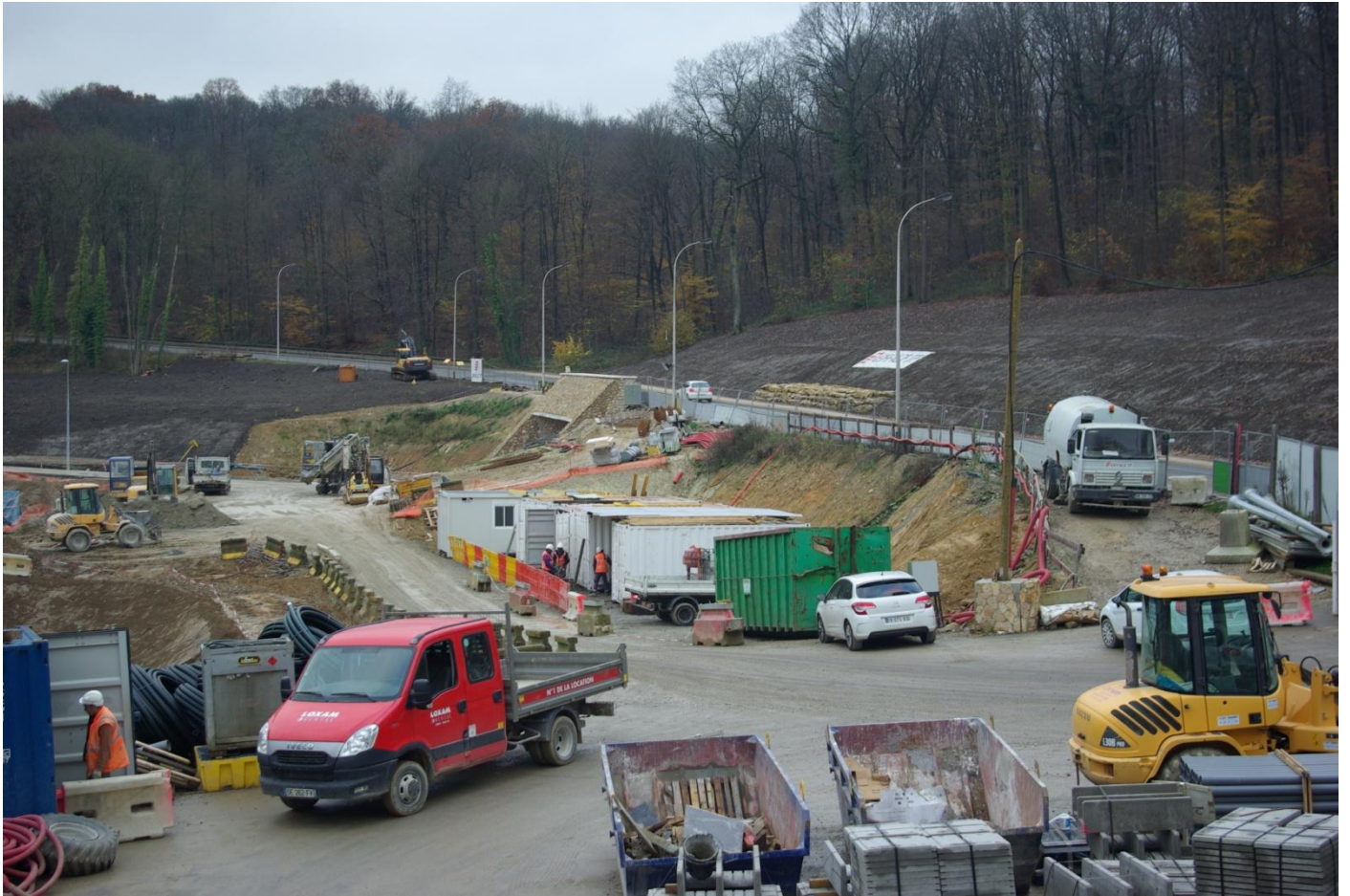
Vue générale de la zone du chantier de construction du tunnel. Nous voyons l'entrée du tunnel en arrière-plan
