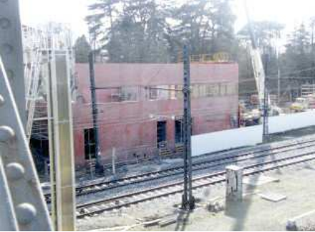
Construction du nouveau PCC de Tassin qui commandera toutes les lignes de l'Ouest Lyonnais
