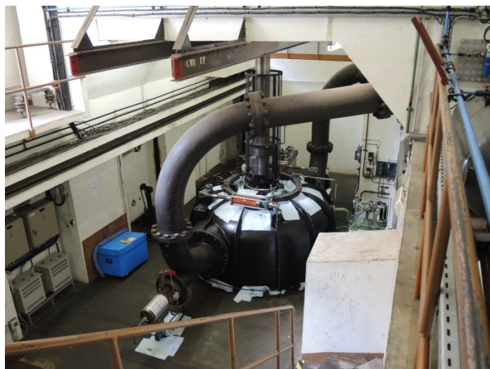
Salle inférieure : une des deux turbines.
