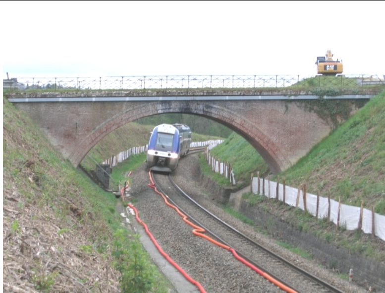
Travaux QNE toulousain : un pont devant être démolit et reconstruit, celui du PK 373,532 à GEMIL (10-04-2011- photo Michel Fourment AFAC)
