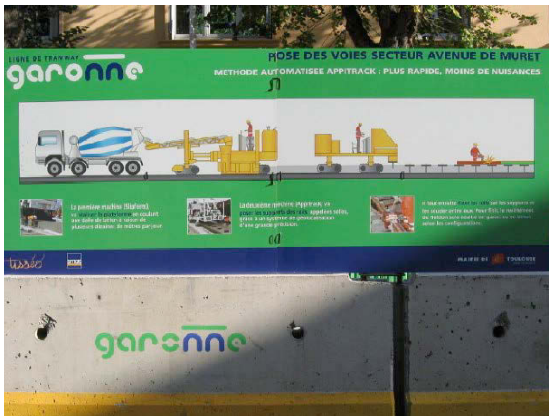
Panneau posé sur la clôture du chantier expliquant succinctement la méthode aux passants.
